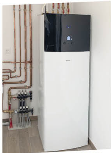
POMPE À CHALEUR
